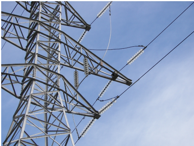
FIGURA 9.10: Cruzamiento de líneas en una red aérea para aumentar la protección contra sobretensiones.
