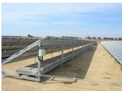
(A) Sistema conectado a red instalado sobre suelo.
